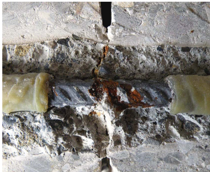
Abb. 4.9 Seitlich ausgedehnter Korrosionsangriff am normalen Betonstahl im Rissbereich, ergänzende Versuche mit Rissbildung an der HSR
